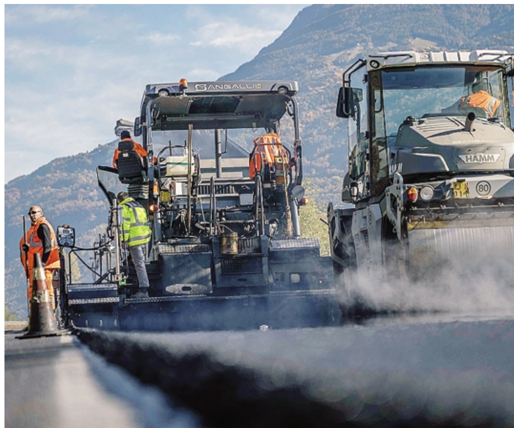
Una squadra Sangalli all'opera sul fronte della manutenzione stradale: l'azienda ha più di cento addetti
